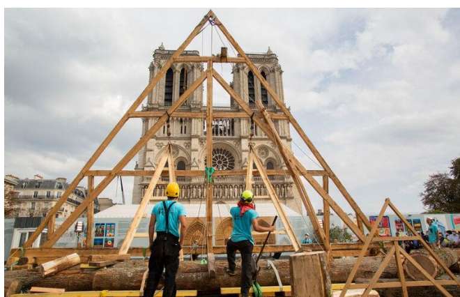
Visuel 2 – Journées européennes du patrimoine 2020 - Démonstration de levage de charpente depuis le parvis de la cathédrale Notre-Dame de Paris © Patrick Zachmann / Magnum Photos – Utilisation soumise à conditions
