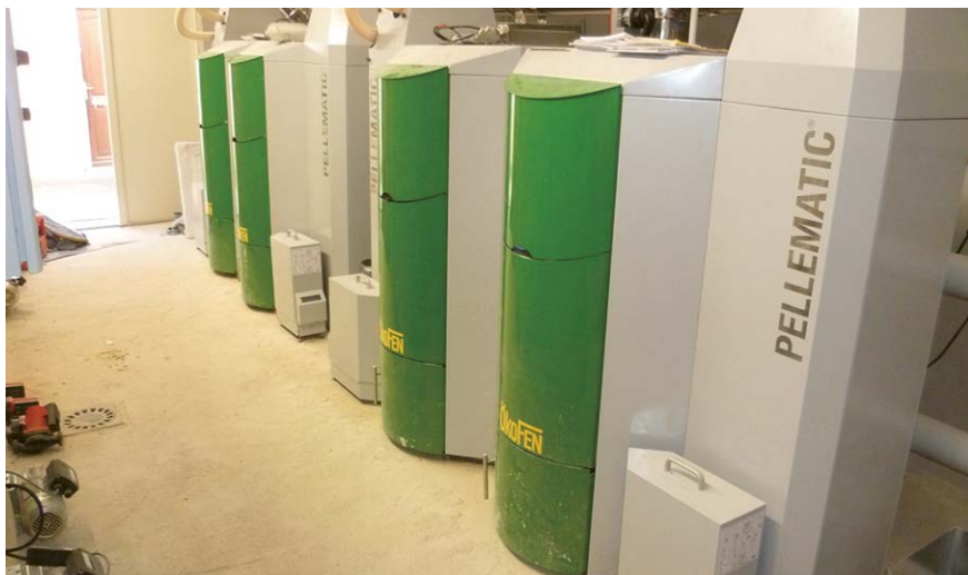
▲ À Dieulefit, dans la Drôme, quatre chaudières à granulés installées en cascade alimentent une salle de spectacle de 400 places et les locaux de la mairie.
